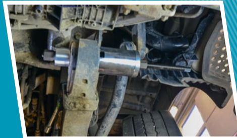
Wyciąganie uszkodzonego gniazda
